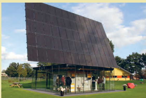
Der Solartracker auf dem Dach des Info-Pavillons
