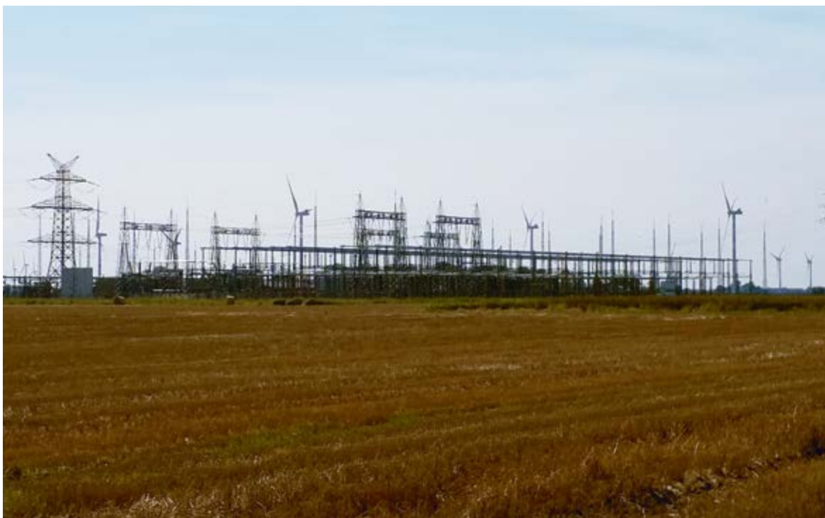
Umspannwerk in St. Michaelisdonn
